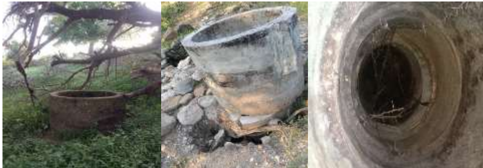
Gambar 4.1 Sumur yang tidak di rawat
