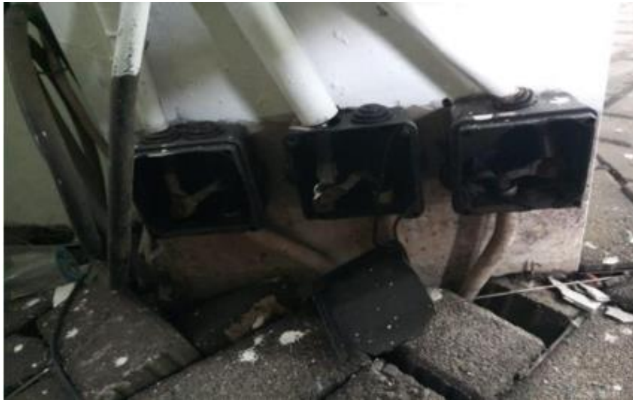
Gambar Konduktor Pada Gedung MCEB
