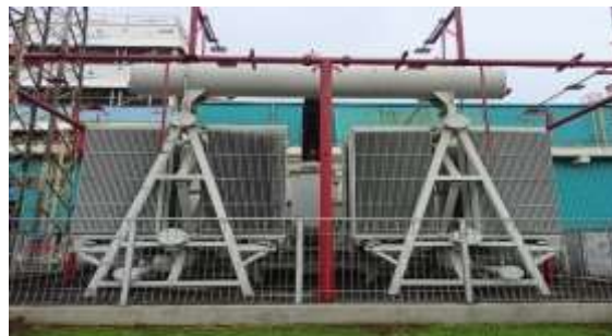
Gambar 3.1 Transformator Daya PLTGU Muara Tawar
